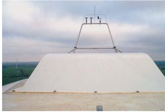
Figura 3.6. Protección contra rayos de anemómetros situados en un aerogenerador.
